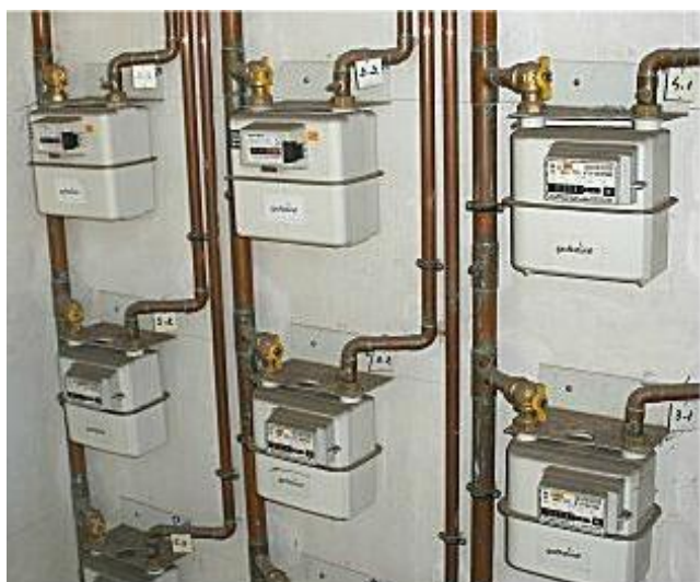
CONTADORES DE GAS
