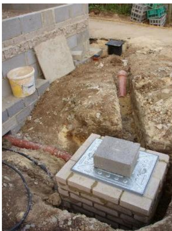
ARQUETA DE REGISTRO
